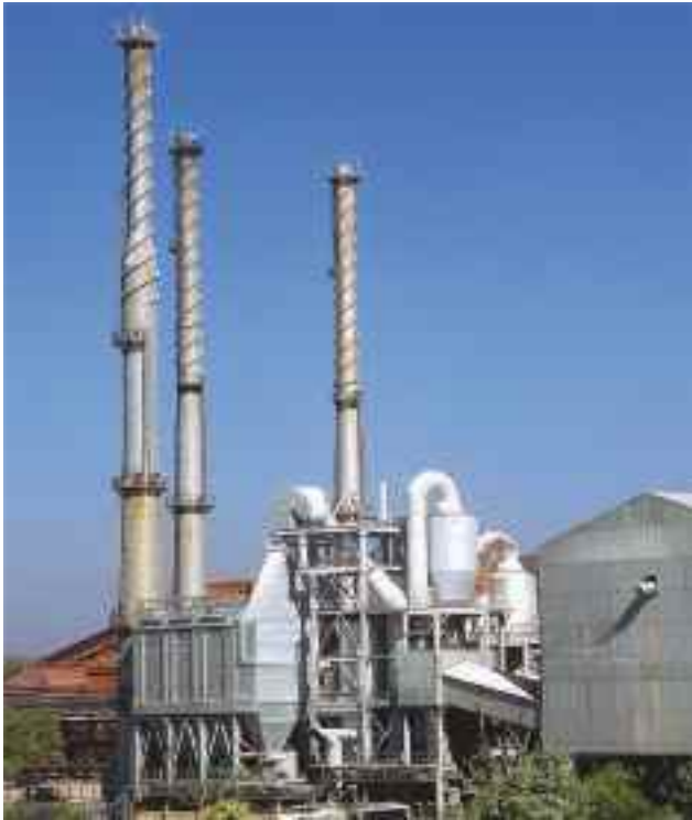
रिफाइनरी में केलसीनर प्लांट
