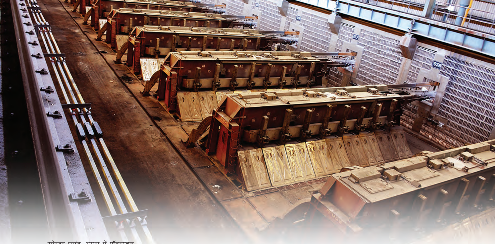
स्मेल्टर प्लांट, अंगुल में पॉटलाइन
